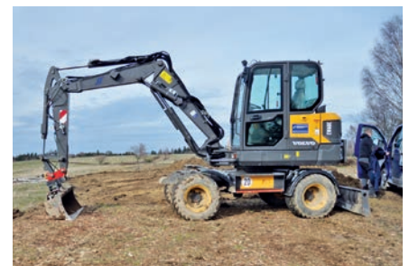
Mit dem Bagger wurde eine Rohbodenfläche freigelegt, die nun typische Arten der Heiden und Magerrasen neu erobern können.
